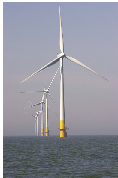
Slika 10.1 Kentish Flats – vetrna elektrarna v plitvih vodah. Rotorji s premerom 90 m so nameščeni na višini 70 m. 3-megavatne turbine tehtajo po 500 ton, polovico od tega temelji. Foto: © Elsam (elsam.com). Objavljeno z dovoljenjem.
